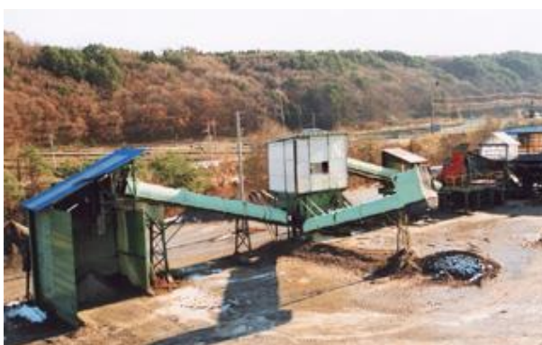
<瓦礫類の破碎施設>
